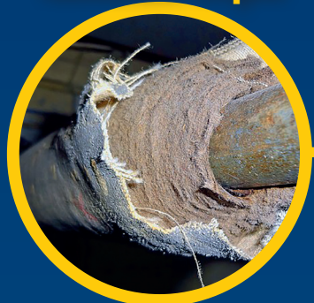
Tubazioni riscaldamento e centrali termiche
