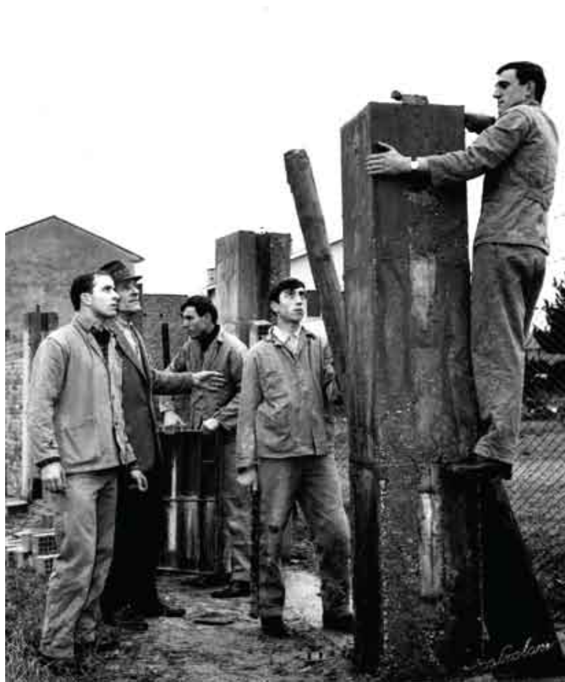
La Scuola Edile di Mantova nasce nel 1949: nella foto alcuni suoi allievi all'opera.
